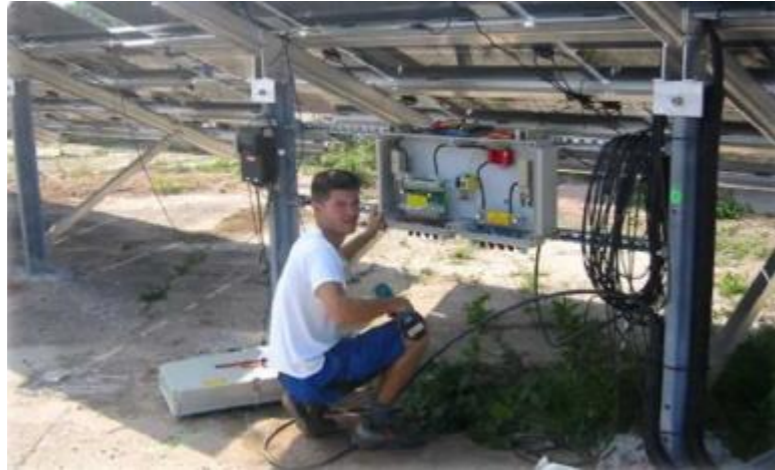
Figure 16 : Système électrique sur un parc photovoltaïque (Source : Solvéo)
